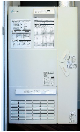
図 4.2.3.4 空調機本体(右側が全熱交換器ユニット)
