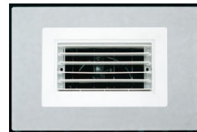
各室への換気口
