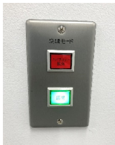
図 3.2.4.11 自然換気(ハイブリッド換気)有効ランプ
