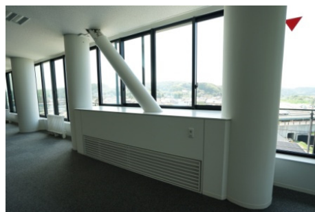
図 3.2.4.9 自然換気窓とダンパー付換気口
